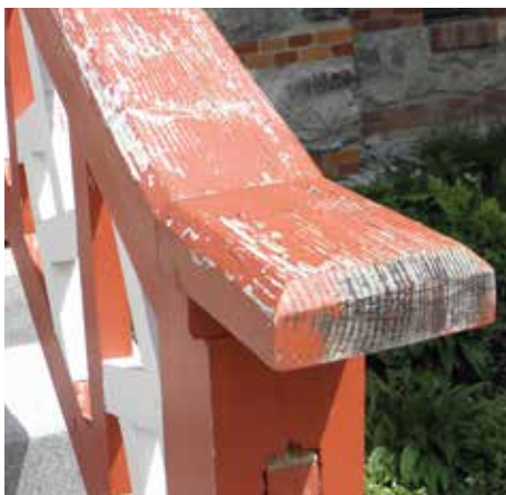
Odpráskaný nátěr na bázi vody ca. po 1 roce vystavení povětrnosti
