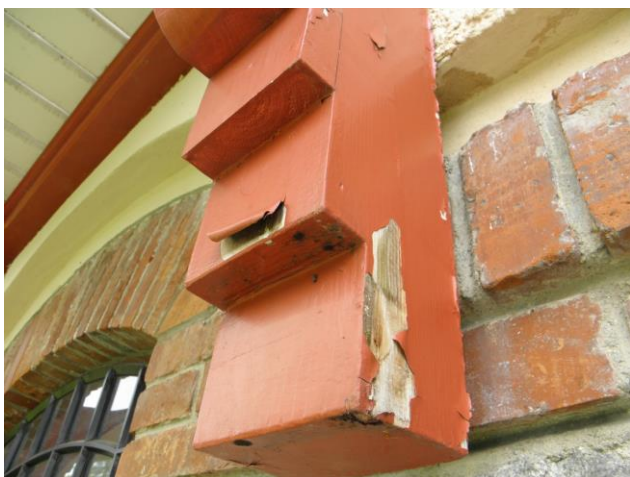
Popis obrázku: Odprýskaný nátěr na bázi vody
