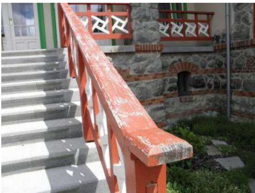
Popis obrázku: Odprýskaný nátěr na bázi vody
