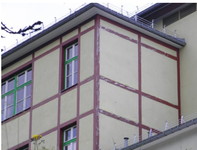
Popis obrázku: Odprýskaný nátěr na bázi vody
