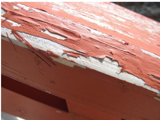
Popis obrázku: Odprýskaný nátěr na bázi vody
